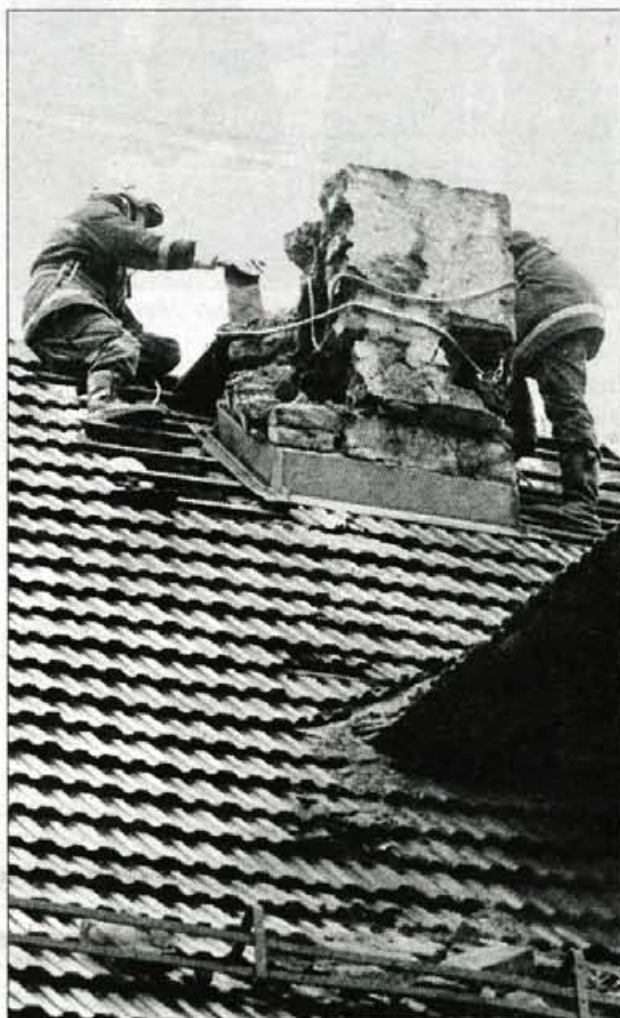
Jeseniški gasilci pri poškodovanih dimnikih.
