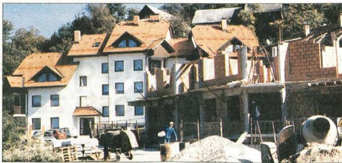
Neprofitna stanovanjska gradnja na Mlaki pri Tržiču: že zgrajena stanovanja in stanovanja v gradnji.
