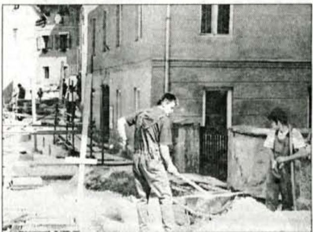
Partizanska ulica v Tržiču je veliko gradbišče - Tržič, 23. maja - Stari del Tržiča, v katerem je tudi Partizanska ulica, napaja stoletje star vodovod. Ker so bile cevi v tej ulici popolnoma dotrajane, se je Komunalno podjetje Tržič aprila lotilo zamenjave vodovoda, obenem pa prenavlja tudi kanalizacijo. Za ta dela, ki jih financirajo iz ekološke takse, bodo porabili okrog 15 milijonov tolarjev. Hkrati poteka tudi prenova telefonske in električne napeljave, po ulici pa bodo napeljali še cevi za plin in kabelsko televizijo. Kot predvidevajo v uradu tržiške občine za urejanje prostora, bodo dela končali do sredine avgusta, ko bo Partizanska ulica ponovno odprta tudi za promet z vozili. • S. Saje
