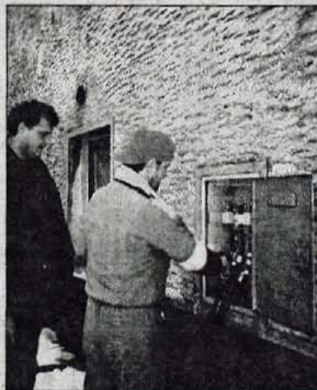
Priklapljanje provizorija v nizkonapetostni hišni omari.
