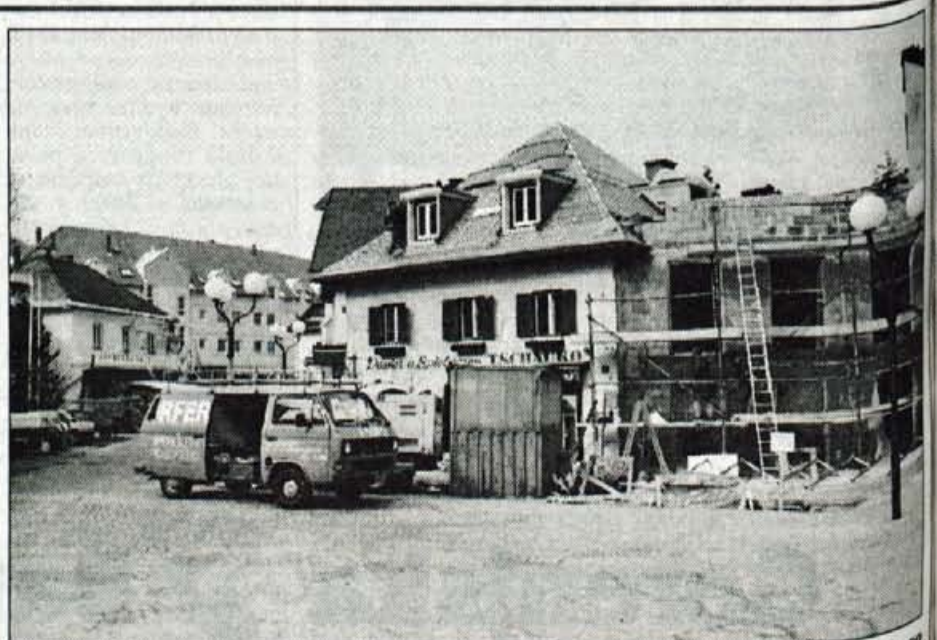
Borovlje - V pripravah na deželno razstavo, ki bo letos od maja naprej v Borovljah, so med drugim poleg ureditve razstavnega paviljona tudi obnovili Glavni trg, fasado na sedežu občine, te dni pa hitijo z deli tudi na stavbah na severni strani trga. Razstava bo vsekakor dogodek desetletja za Borovlje in okolico in na njej pričakujejo tudi obiskovalce iz Slovenije. • M. A., foto: Gorazd Šinik
