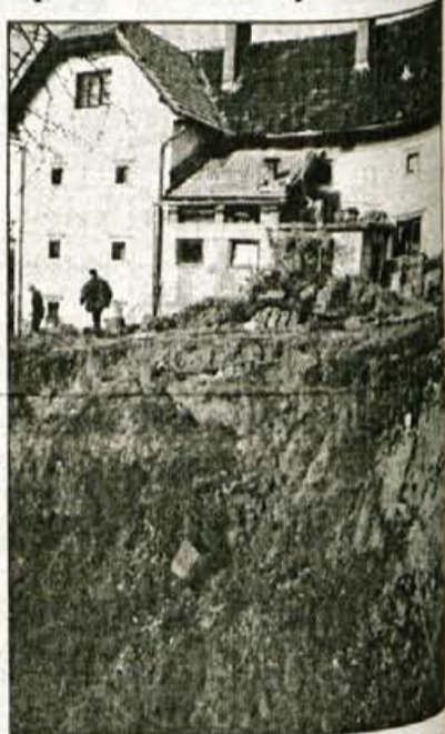
Ob Grosovi hiši na Brdu je deževje sprožilo plazenje brežine nedaleč stran od temeljev stavbe.
