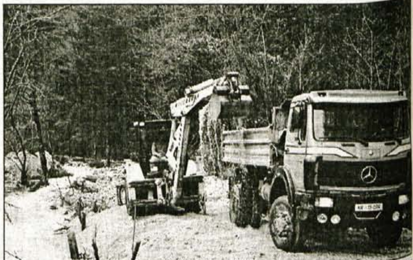
Strugo Belega potoka v Podlublju so začeli ponovno urejati po novembrskem neurju, nujno pa bo zgraditi oporne zidove pri Tominčevi domačiji.
