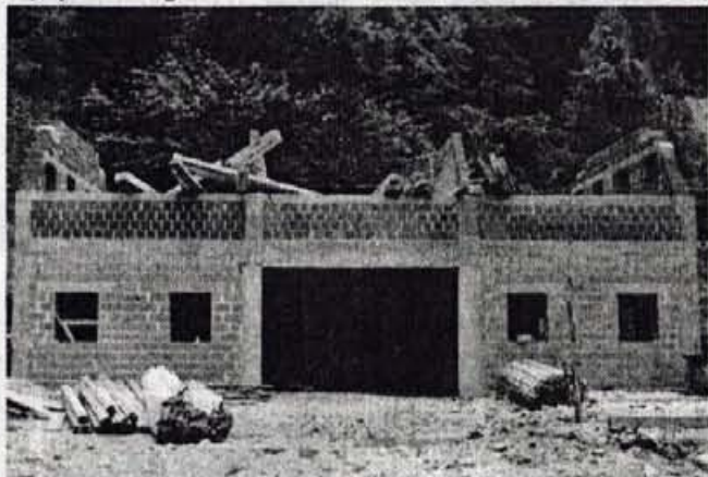
Skladišče črpalke so lani začeli graditi brez dovoljenja, sedaj pa je že gotovo.
