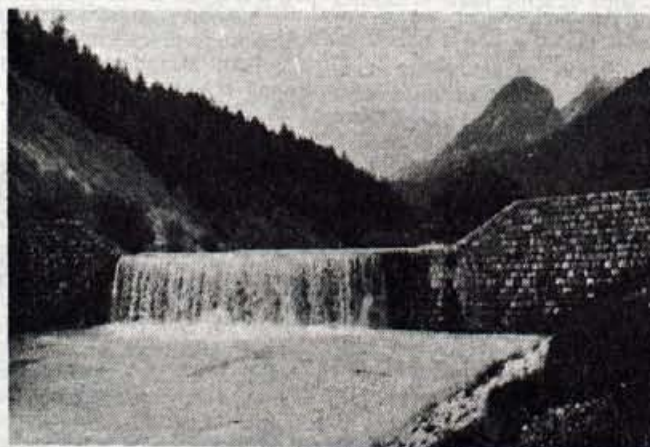
Zaplavna pregrada pri Leku na hudourniku Pišence pri Kranjski Gori (foto: arhiv, PUH Ljubljana)
