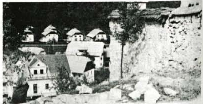
Predvsem zid nad hišami je treba hitro sanirati. Akcije so vsak dan.
