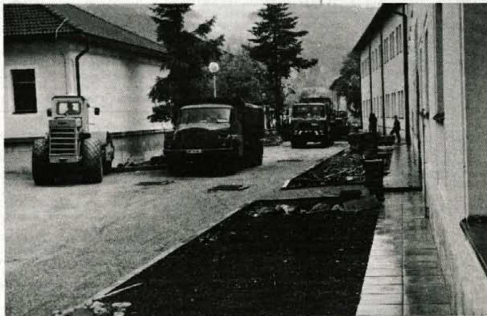
NOVA PODOBA VOJAŠNICE NA BOHINJSKI BELI - Prve vojake pričakujejo v tej vojašnici sicer šele začetek oktobra, vendar mora biti prenova stavb končana že dva meseca prej. Od konca marca naprej so rekonstruirali 8 starih objektov in postavili enega novega. V prostorih že vsa oprema. Ko bodo uredili še okolico, bo pogled na vojašnico mnogo lepši kot v preteklosti. (Več na Odprtih straneh) S. Saje - Foto: P. Kozjek
