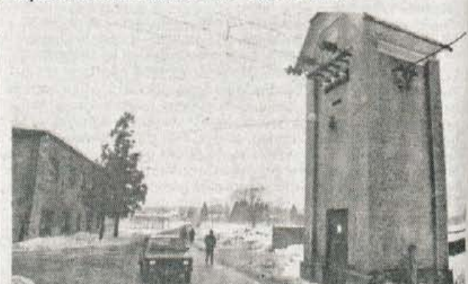
Stolpasta transformatorska postaja v Križah se zaradi razširitve regionalne ceste "umika" nasproti objekta Zlit.
