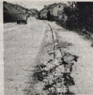
Tako izgleda veliko slovenskih cest, kajti armada jih je uničevala namerno, kar je iz foto zapisa o zdrobljenih robnikih in razkosanem asfaltu očitno.
