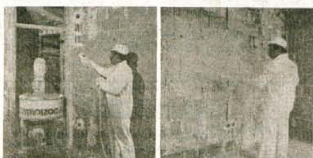
Ekipo za ometavanje s TERMOFIX sestavljajo 3 delavci. Ekipo naredi pri normalnih okoliščinah 100 do 150 m 2 ometa v 8 urah, seveda pa je odvisno tudi od debeline nanašanja, velikosti prostora in letnega časa.
