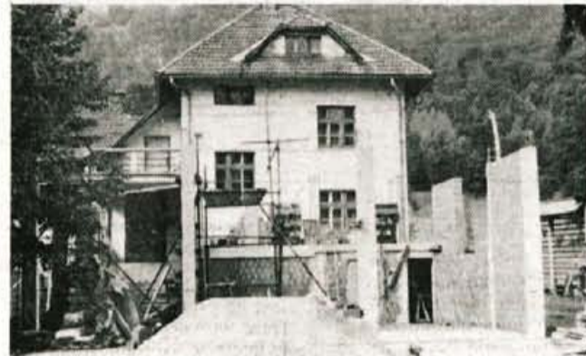
Ob stavbi šole in vrta Dobravci s samoprispevkom gradijo gasilsko orodnišče in večnamenske prostore.... - Foto: D. Sedej
