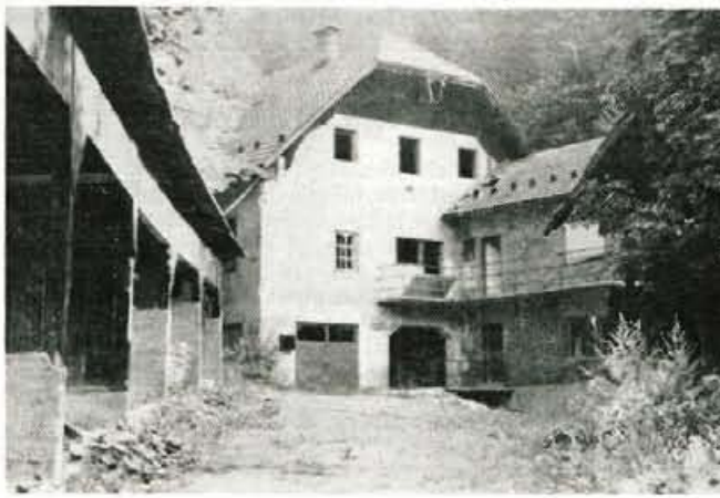
Stavba na Zgornjem Plavžu je v obupnem stanju. V zadnjih dveh letih, ko jo občina ni hotela vrniti lastniku in je ni zavarovala, je popolnoma propadla... - Foto: D. Sedej
