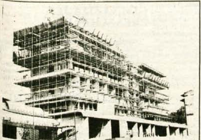
Kranj, avgusta - Nova stavba UNZ Kranj, v kateri bo tudi kranjska postaja milice, nezadržno raste pred našimi očmi. Naložba je poleg kranjskega olimpijskega bazena največja družbena investicija na Gorenjskem. Obetajo, da bo stavba končana in odprta do 13. maja prihodnje leto, za dan varnosti. - Foto: F. Perdan
