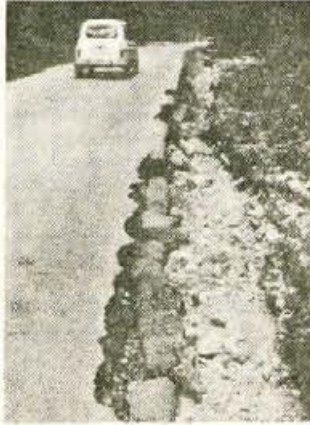
Takole je na Jezerskem spodkopalo asfaltno cesto.
