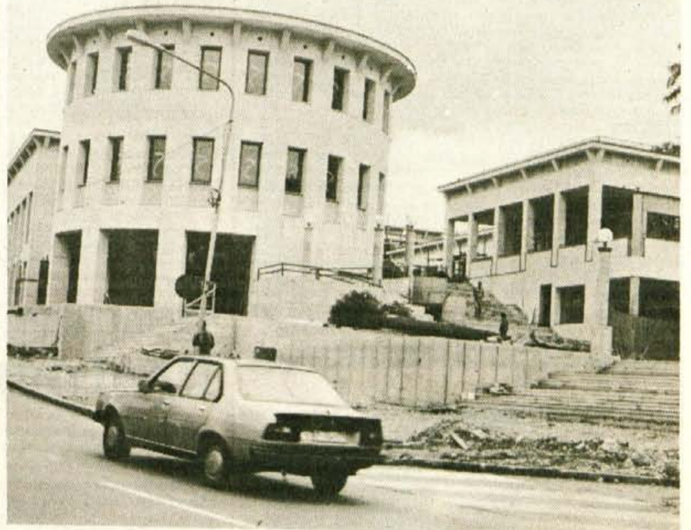
Jutri, 5. avgusta, praznujejo v radovljiški občini, kjer so v zadnjem letu veliko naredili. Bled se pripravljajo na svetovno veslaško prvenstvo pa tudi sicer bogati turistično ponudbo. Gradnja trgovskega centra (na sliki) se približuje koncu. - C.Z.
