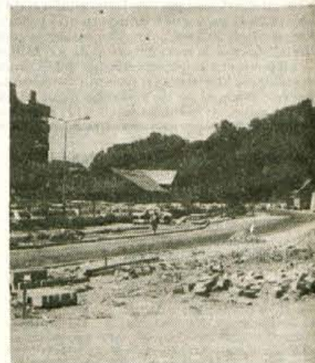
Trenutno potekajo še zadnja dela na že lani začetem urejanju mestne vpadnice...
