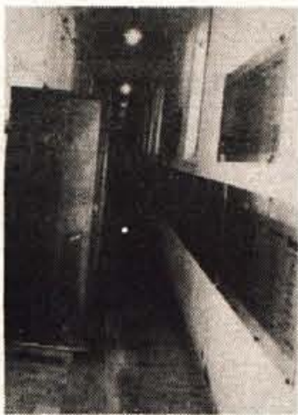
nja pregledovali stavbo, so ugotovili, da je potrebna prvenstveno zamenjava strehe in drenaža
