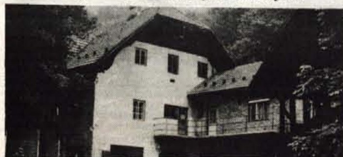
Streha se nevarno nagiba, v spodnje prostore vdira kanalizacija. — Foto: D. Sedej
