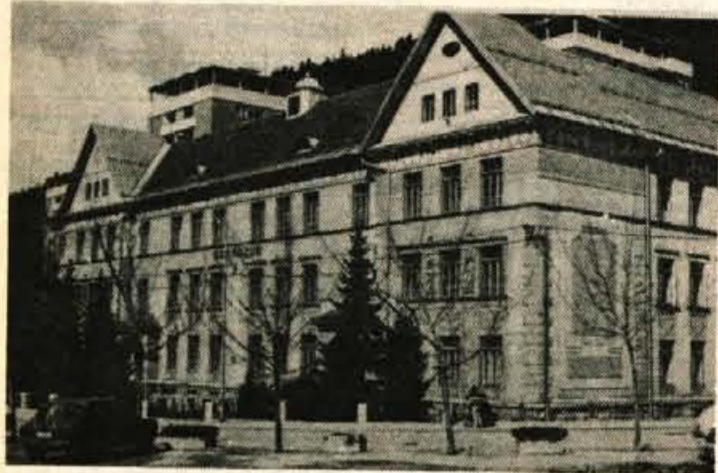
Republiška izobraževalna skupnost je jeseniški gimnaziji dala denar za nakup opeke za prekritje strehe, vendar na gimnaziji nimajo denarja, da bi plačali obrtniška dela. Opeka zato leži pred stavbo in propada... Foto: D. Sedej
