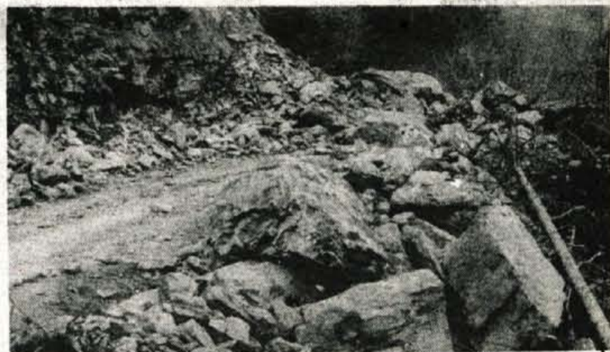
Trebija, 18. novembra — Cesta Trebija—Žiri bo do 28. novembra zaprta za ves promet. V petek, 18. novembra, se je namreč nad Fužinskim jezom odtrgal večji plaz. Tega so odstranili, vendar so se potem sprožili novi. Obvoz je določen na relaciji Žiri—Lučine—Gorenja vas—Škofja Loka, in obratno. Alpetour bo skrbel tudi za avtobusni prevoz.
