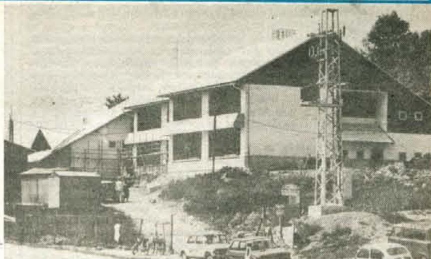
V Poljanah gradijo osnovno šolo — SGP Tehnik iz Skofje Loke s soizvajalci gradi v Poljanah novo osnovno šolo na osnovi referendumskega programa. Gradnja poteka po programu, želja krajanov pa je, da bi bila šola do njihovega krajevnega praznika odprta. (jk) — Foto: F. Perdan
