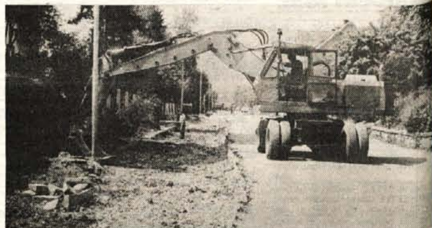
Obnova ceste Staneta Žagarja v Kranju — Komunalno gradbeno podjetje Kranj je minuli mesec začelo urejati pločnike in obnavljati Cesto Staneta Žagarja od križišča z Ulico Moše Pijadeja do križišča z Oldhamsko cesto. Preden bodo uredili pločnike, bodo morali obnoviti vodovod, javno razsvetljavo, položiti elektrokabelsko kanalizacijo in pti inštalacije. Dela bodo stala prek 100 milijonov dinarjev, rok za dograditev pa je 19. avgust. — A. Ž. — Foto: F. Perdan
