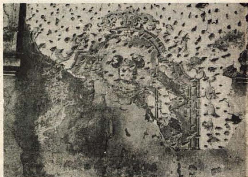
Kranj, marca — Dotrajan žleb na Pečnikovi hiši v Prešernovi ulici št. 16 je »zagrešil« odkritje baročne freske. Z razpadajoče strehe, ki jo lastniki že nekaj časa ne popravljajo, pošteno zamaka. Namočena fasada je popustila, dve plasti ometa sta padli na ulico, s stene pa je zasijala barvita in kvalitetna baročna freska sv. Florijana. Po mnenju direktorice Zavoda za spomeniško varstvo Kranj Olge Zupanove bo verjetno tudi na levi strani spomeniško sicer zaščitene stavbe pod ometom še druga poslikava. Morda pa bodo pod to baročno fresko našli še kakšne starejše poznogotske poslikave, kot so jo odkrili pri obnovi fasade na Pavšlerjevi hiši. — L. M. — Foto: F. Perdan
