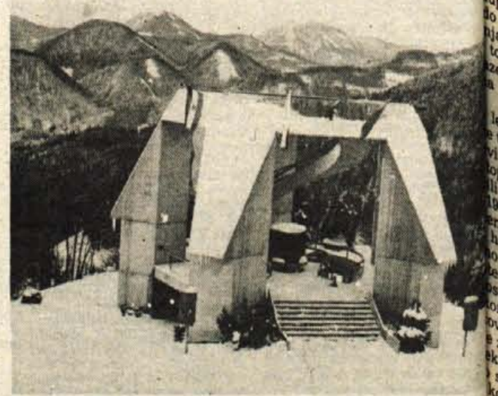
Devet let je, odkar stoji spomenik dražgoški bitki, a razpoke in vodoravne opozarjajo, da v njegovih temeljih ni vse v redu. Foto: F. Perdan
