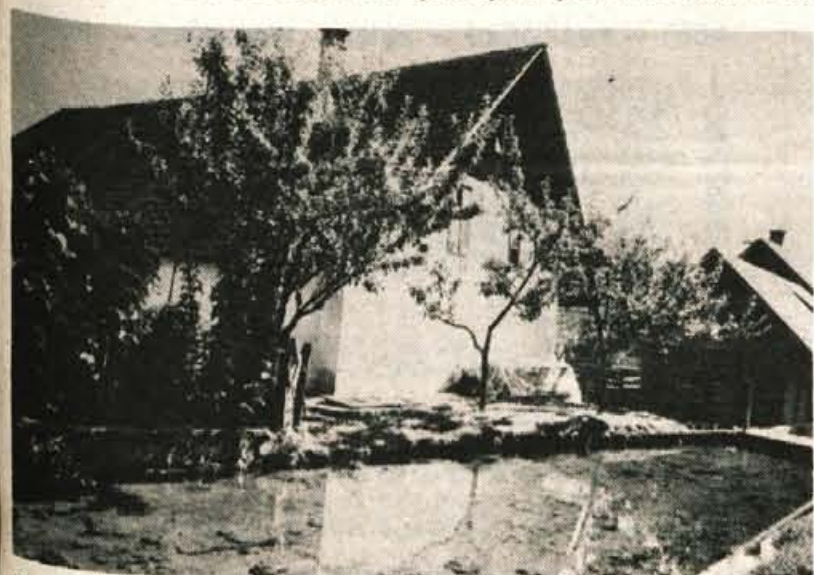
Najprej bi bilo treba zgraditi betonsko brežino ob potoku Pretovka, ki zamaka, saj teče tik ob poslopju. Foto: F. Perdan
