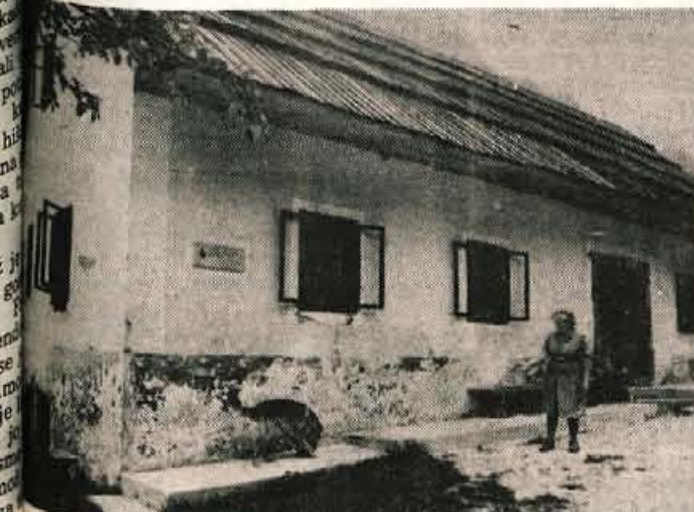
SA JE POTREBNA OBNOVE — Nekaj obnavljajo tudi sami, na primer, na novo prekrili skedenj, toda na popravilo stolnika, ki ne vleče, čaka Francka Lindav že več kot leto.
