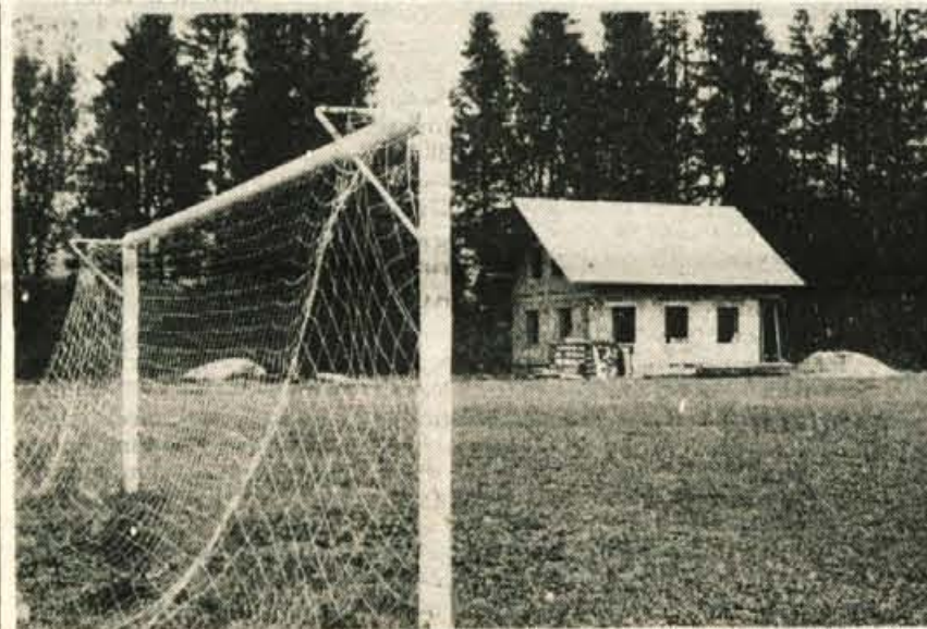
V mesecu dni so na rekreacijskem prostoru zgradili stavbo, ki bo športnikom služila za garderobe in sanitarije.
