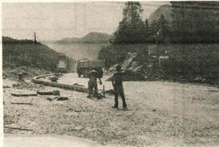
Za nasipanje trase so porabili izkopani material, polovico peska pa so pripeljali iz Naklega — za tako imenovani cestni tampon.
