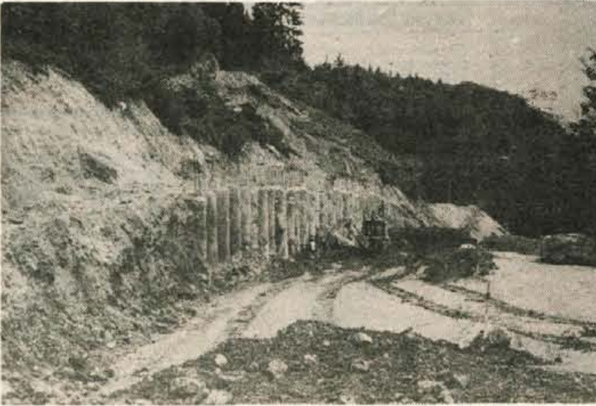
V mesecu dni bo prebitih zadnjih 500 metrov pred drugim mostom, kjer so gradbena dela zahtevna, postaviti so morali oporne stebre.
