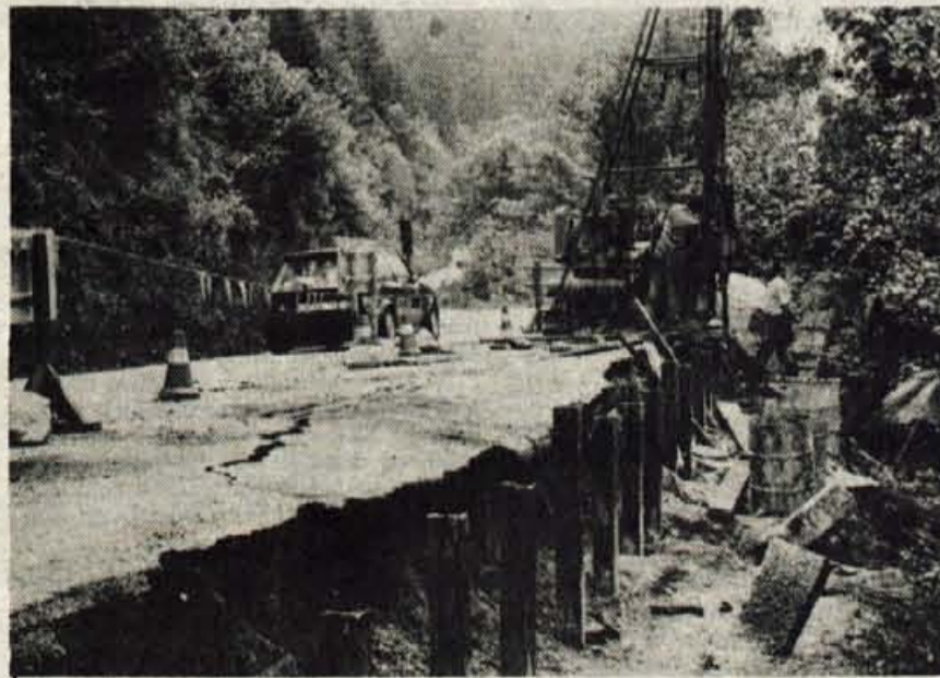
Popravilo ceste na Korensko sedlo — Delavci Cestnega podjetja Kranj in Geološkega zavoda iz Ljubljane so opravili geološke raziskave na cesti proti mejnemu prehodu Koren. Cesta se je udrla na dveh krajih, nastajale so vedno večje razpoke, zato so morali prepovedati promet za težka vozila in avtobuse, pred nevarni odsek pa so postavili semaforje in opozorilne table. Zdjaj pri udoru zabijajo »pilote« in gradijo oporni zid, dela pa bodo predvidoma končana do konca tega meseca. — Foto: D. Sedej
