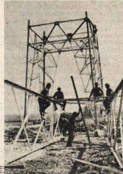
Do nove razdelilne transformatorske postaje Okroglo bo od podobne v Beričevem postavljena 400-kilovoltna daljnovidna, ki ga že gradijo, nared pa bo do konca leta. Nov daljnovid bodo nato zgradili tudi od Kranja do Jesenic, saj se bo z novo elektroprojektno poraba elektrike na Gorenjskem močno povečala. Foto: F. Perdan
