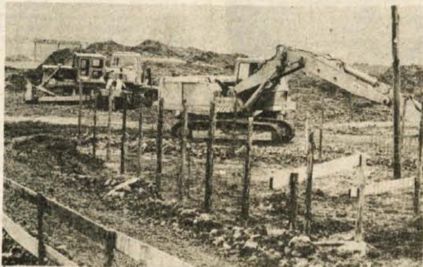
Gradnja jeklarne na Beli — Pri gradnji elektrojeklarne dela nekoliko kasnijo. Največ dela so imeli pri izbiri projektantov dobaviteljev domače opreme in izvajalcev montažnih del. V Sloveniji so namreč zahtevali dodatno preverjanje sposobnosti organizacij, ki bodo jeklarne gradila. Zato so lahko šele dva meseca po prijavi naložbe podpisali pogodbo s poslovno skupnostjo Rudis Trbovlje. — Foto: F. Perdan
