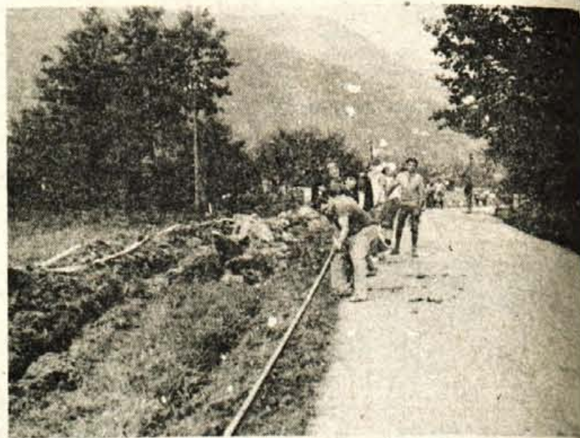
V sredo, 22. avgusta, so krajanje v smeri proti Česnjevku polagali kable glavni telefonski vod. Strojni izkop v tej akciji je vodil predsednik krajevene skupnosti Velesovo Anton Ropret , vodja gradbenega odbora v delovni akciji pa je Milan Sajovic iz Velesovega .
