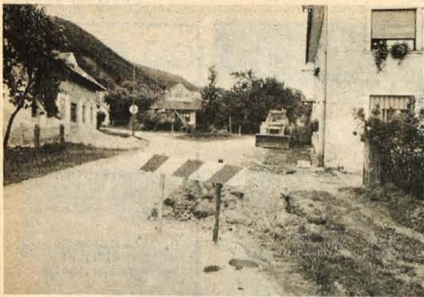
Letos vodovod Grad-Cerklje — Največja letošnja vodovodna akcija v kranjski občini je obnova obstoječega vodovoda Grad-Cerklje. Stare cevi v premeru 60 do 80 milimetrov bodo zamenjale nove v premeru 160. V zgornjem delu, v Gradu, je cevovod že položen in delajo priključke do porabnikov, dela pa napredujejo tudi v Dvorjah. Po obveznem klariranju bodo vse hiše priključene na novi vodovod. Letos naj bi bila končana prva faza; druga, od Cerkelj do Brnika, je predvidena za prihodnje leto.
