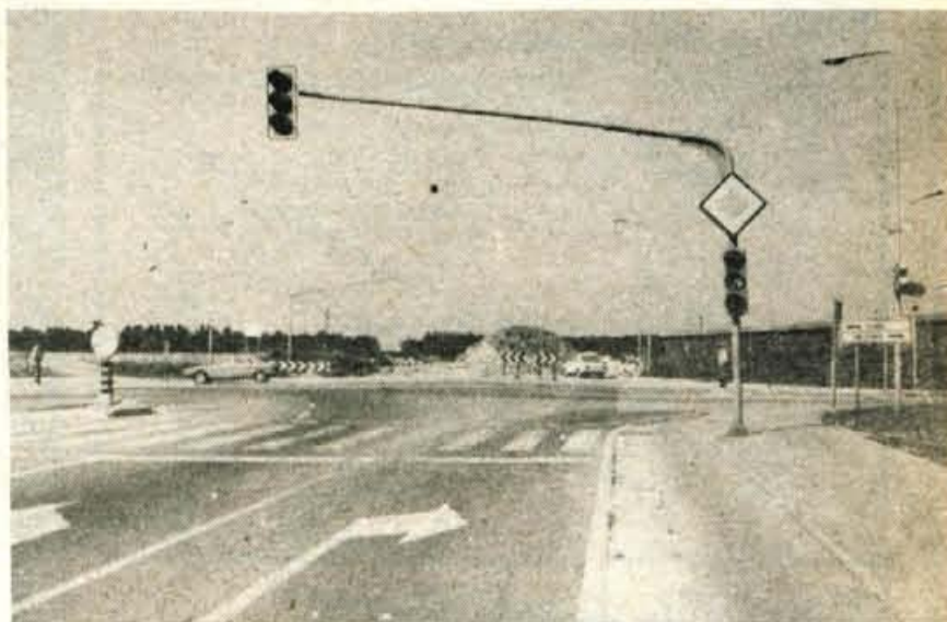
Gradnja vzhodne obvoznice v kranjski občini — Med pomembnejša gradbišča Cestnega podjetja Kranj sodi gradnja vzhodne obvoznice v kranjski občini. Dober poldrug kilometer dolga cesta, ki bo povezovala Delavski most v Kranju z brniško cesto, so začeli graditi marca letos. Najzahtevnejše delo na tem odseku je polaganje 600 metrov dolge kanalizacije. Čevi imajo premer 1,20 metra. Za zdaj dela potekajo po programu, težave pa imajo zaradi pomanjkanja betona. Cesta bo zgrajena predvidoma do 1. novembra letos, vrednost vseh del pa bo znašala okrog 30 milijonov dinarjev. V Cestnem podjetju v Kranju računajo, da se bodo po izgradnji vzhodne obvoznice dela nadaljevala od brniške ceste proti Britofju. — A. Z.
