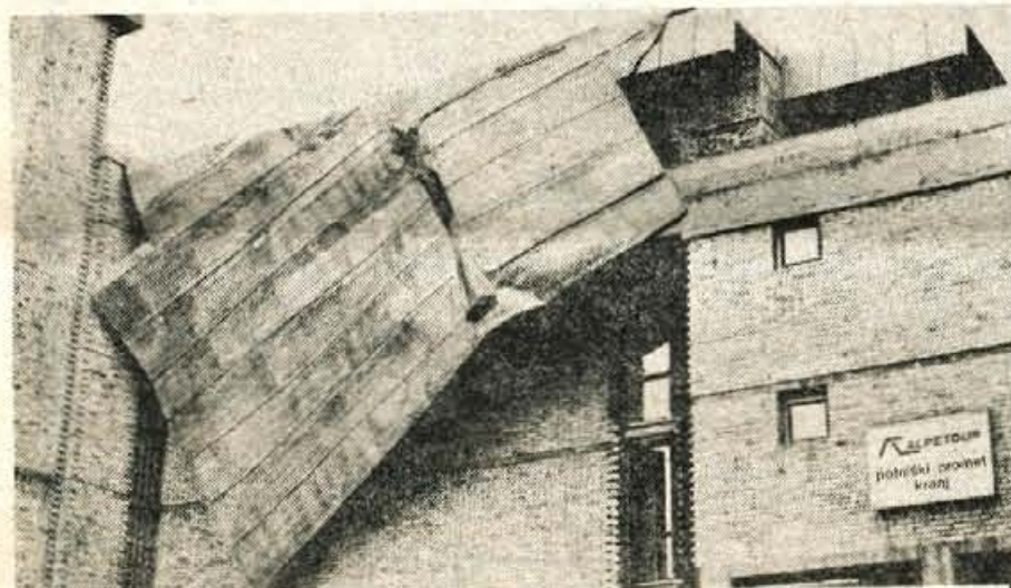
Poškodovana streha hotela Creina — Močan veter, ki je letošnjo zimo že večkrat pihal tudi na Gorenjskem, povzročila nemalo preglavic in škode. Včerajšnje divjanje vetra je ogrožalo predvsem varnost pešcev, ki so jih zajeli posamični sunki na prostem, poškodovalo pa je tudi več ostrejših na raznih objektih. Tako je značni vrtinec okrog polsedme ure zjutraj zajel streho hotela Creina v Kranju in potrgal prek 200 kvadratnih metrov pločevine. V času poročanja škoda še ni bila ocenjena. (S) — Foto: F. Perdan
