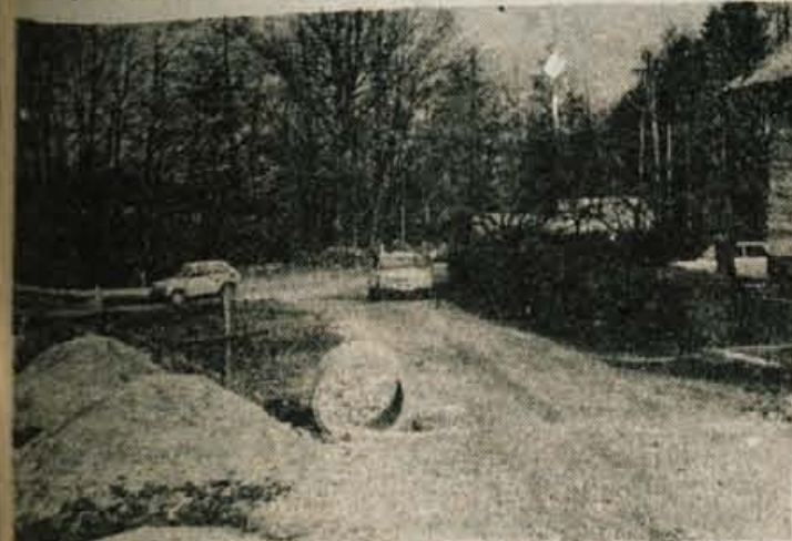
Ze dve leti traja akcija za ureditev kanalizacije in cest na Mlaki. S prostovoljnimi delom in prispevkom ter združenimi sredstvi jo bodo letos končali. Tako bo Mlaka najbolj komunalno urejeno naselje v krajevni skupnosti.
