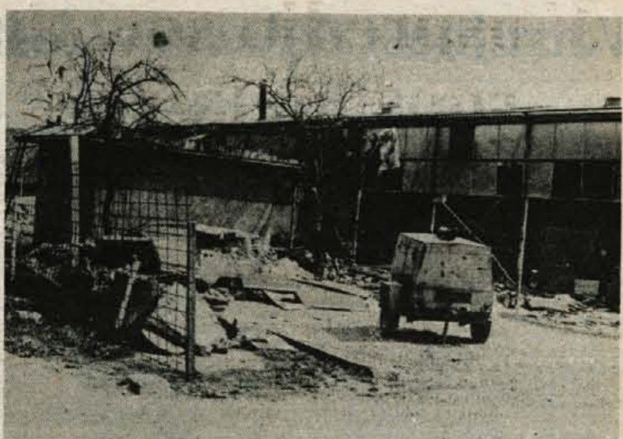
Vse pod eno streho — Te dni so delavci gradbenega podjetja »GRADIS« jesenice začeli podirati staro proizvodno halo Alpetoura na Laborah, kjer je bil dozdaj del proizvodnje kmetijskih strojev in naprav. Delavci Alpetoura so se namreč odločili, da bodo na Laborah razširili servisno dejavnost za Zavestine avtomobile. Zdej so delali v resnično slabih razmerah zaradi utesnjenosti. Novi prostori pa jim bodo omogočili tudi, da bodo končno vendarle imeli vse pod eno streho: kleparsko, avtomobilsko in avtomehanično dejavnost, zraven pa bo tudi prodajalna rezervnih delov za vse avtomobile Zaveste. Razmišljajo sicer še o kakšnem drugem servisu, vendar bodo zaenkrat ostali pri Zavesti. Do konca avgusta naj bi bila po programu zgrajena nova stavba, do jeseni pa naj bi že steklo delo v njej. — Foto: D. Dolenc
