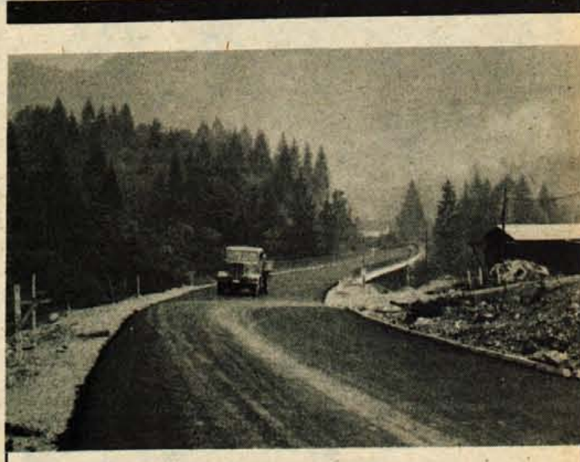
Bohinjska Bela - Delavci Gradbinca Jesenice - temeljne organizacije nizke gradnje so na Bohinjski Beli že postavili dva nova mostova čez Savo Bohinjko.
