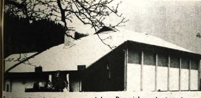
Kolaj štiri leta je stara osnovna šola v Begunjah, pa bo že treba novo streho...
