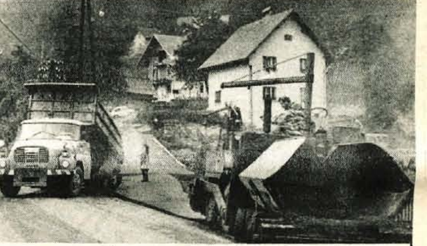
Asfalt na krajevnih cestah Bohinjske Bele - Po domala vseh krajevnih cestah in poteh na Bohinjski Beli so delavci Cestnega podjetja iz Kranja minule dni položili asfalt, tako, da so danes ceste in poti asfaltirane. Tako je krajevna skupnost Bohinjska Bela uresničila dolgoletno željo krajanov, da dobijo tudi na Bohinjski Beli asfalt. Položili so ga na 12.000 kvadratnih metrih površine. - Foto: F. Perdan
