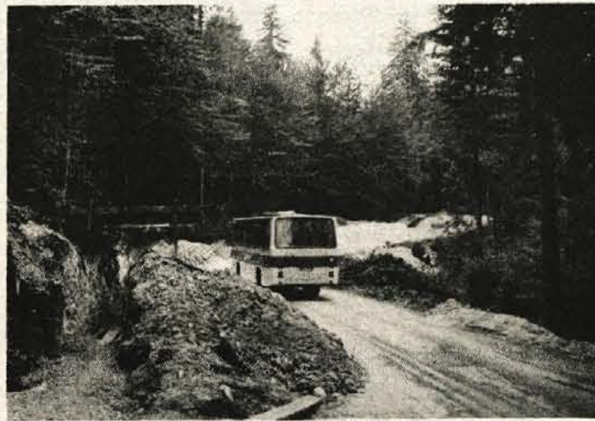
Mladi so od Ribčevega laz do Mladinskega doma zgradili dva kilometra kanalizacijskega in vodovodnega omrežja ... - Foto: F. Perdan
