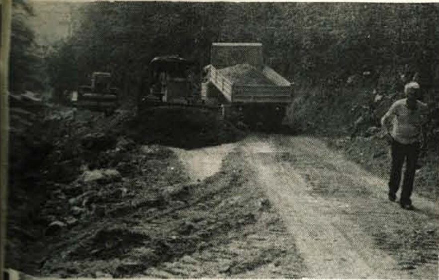
Senturska gora - Na cesti od Grada preko Apnega na Sentursko goro, ki je bila doslej zaradi hudih nalivov, zime in strmega naklona slaba, potekajo vzdrževalna dela. Cesto urejajo sami krajanji. Foto: J. Kuhar
