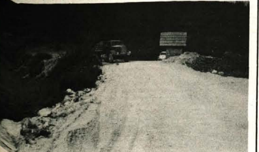
Senturska gora - Dela pri modernizaciji ceste hitro potekajo. Krajanji upajo, da bodo cestna dela končana do letošnjega krajevnega praznika. Foto: J. Kuhar
