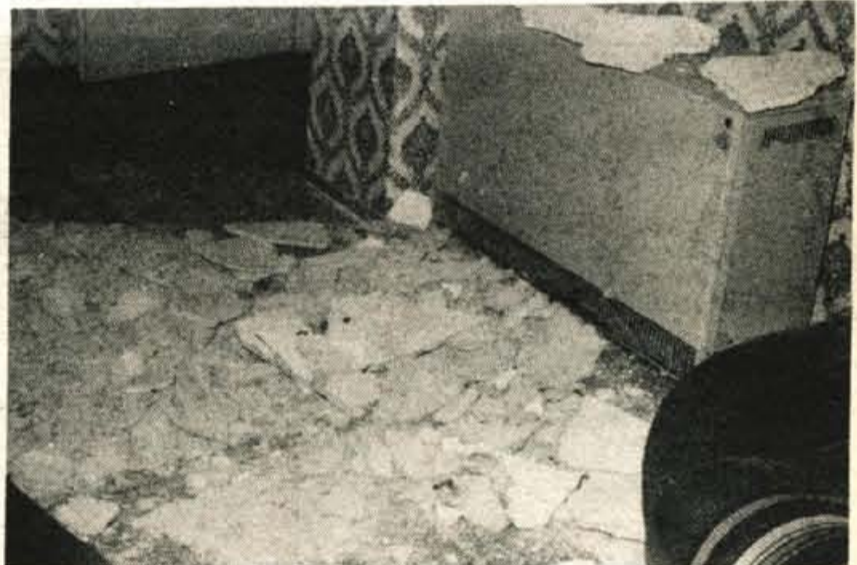
Velika zaplata debelega cementnega ometa stropa dnevne sobe je odpadla in prav lahko se zgodi, da bo strop še kje odstopil.
