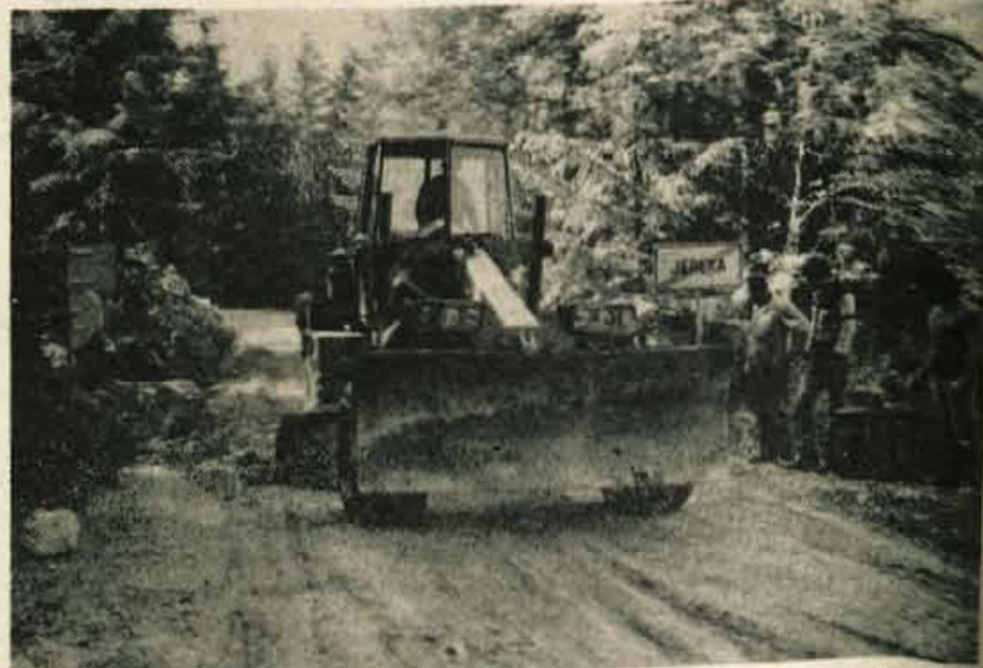
Asfalt na Koprivnik – Takole so začeli delavci Cestnega podjetja Kranj pripravljati deli za asfaltiranje ceste od Jereke do Koprivnika. Zemeljska dela so že opravili, položili tudi del asfalta. Cesta na Koprivnik bo široka štiri metre, z razširitvami v ovinkih, dolga pa šest kilometrov. Asfaltiranje je financirala republiška skupnost za ceste, dela pa so veljala predvidoma več kot 10 milijonov dinarjev. – Foto: D. Sedej
