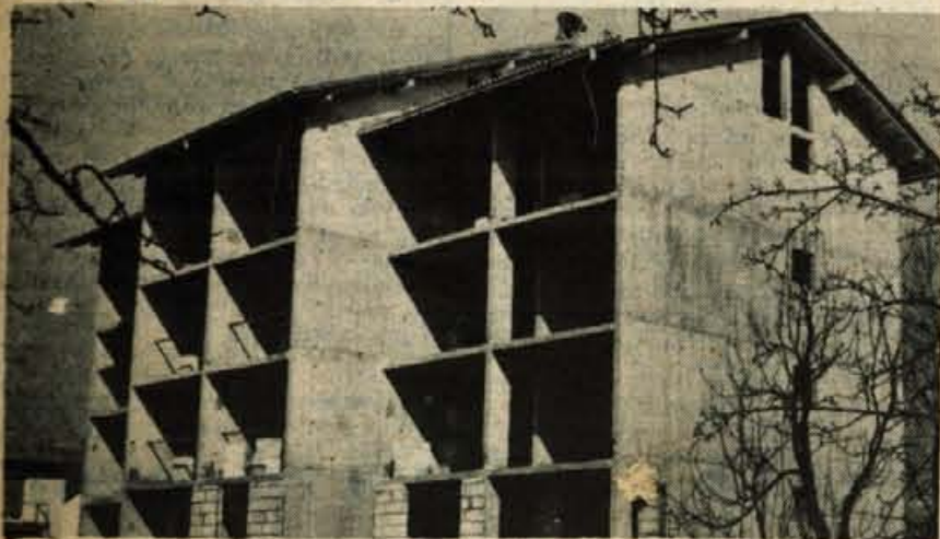
NOVA STANOVANJA V STRAŽIŠČU - V Šolski ulici v Stražišču gradijo nov stanovanjski objekt z 18 stanovanj, ki bo vseljiv najkasneje jeseni. Novih stanovanj so še posebno veseli delavci osnovne šole, saj je kar 7 stanovanj namenjenih pedagoškim delavcem, drugih 11 pa bo razdeljenih med delavce Save, borce in pričakovalce stanovanj iz solidarnostnega sklada. (jk) - Foto: F. Perdan
