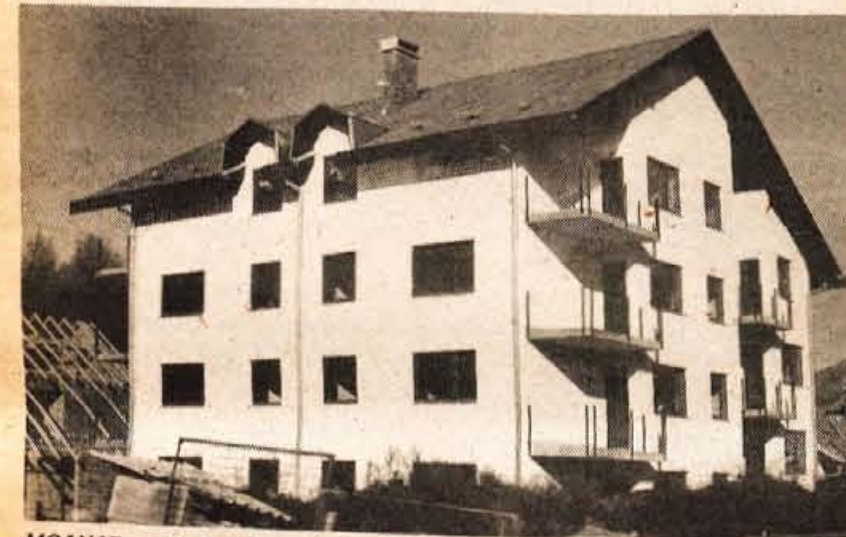
MOSNJE — Predvidoma bodo ob letošnjem dnevu republike v krajevni skupnosti Mošnje odprli nov stanovanjski blok, v katerem bodo tudi prostori krajevne skupnosti ter trgovina Špecerije Bled. Stanovanja bodo namenjena zaposlenim delavcem, med njimi tudi delavcem in učencem delovne organizacije Grad Podvin v Podvinu. — Foto: F. Perdan
