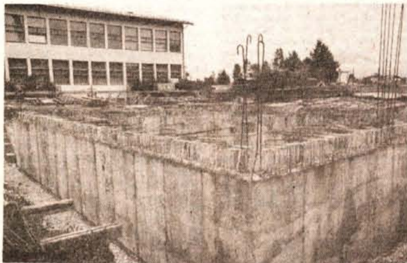
Ob osnovni šoli gradi gradbena organizacija Graditelj novo telovadnico in kuhinjo. Z gradnjo prispevajo tudi krajan s samoprispevkom - Foto: F. Perdan
