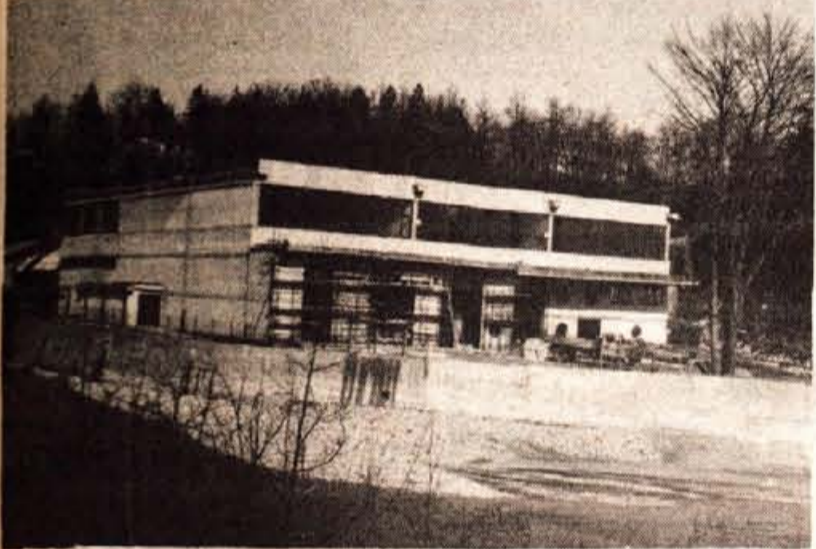
Navadno gradimo nove proizvodne hale zato, da bi širili proizvodnjo. Kranjski IKOS pa je želel le normalne delovne pogoje. Dolga leta se je s svojo zahtevano proizvodnjo strojev stikal v nemogočih delovnih prostorih, zdaj so pa le lažje zadihali. Pa tudi zunanji videz delovne organizacije je zdaj vse drugačen. — Foto: D. Dolenc
