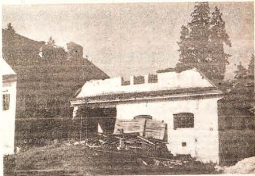
Zaradi dotrajanosti nosilnih lesenih stebrov se je sesedla streha na gospodarskem poslopiju. — Foto: F. Perdan
