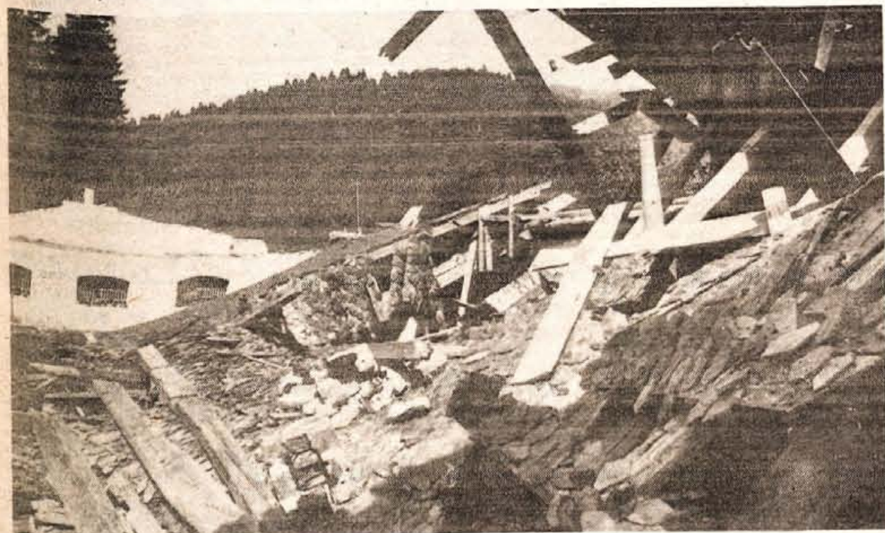
Ostanki skrlijaste strehe — Foto: F. Perdan
