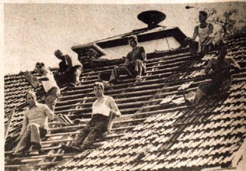
Razbiti strešniki – Kot jajce debela toča je na strehah hiš kot za šalo potolkla strešnike, tako da so morali kot na hiši v Srednji vasi zamenjati kar precej strešnikov. – Foto: F. Perdan
